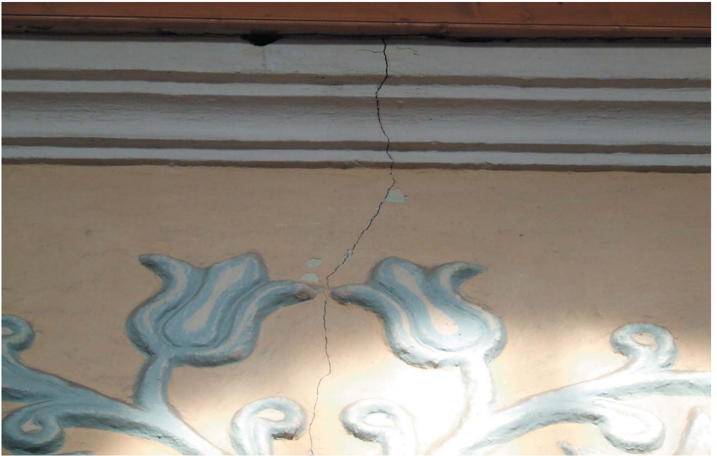
Evanjelický a.v. kostol v Hybiach - pohľad na satatické poškodenie
